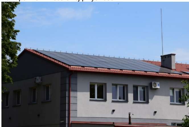
Panele fotowoltaiczne na budynku Urzędu Gminy
